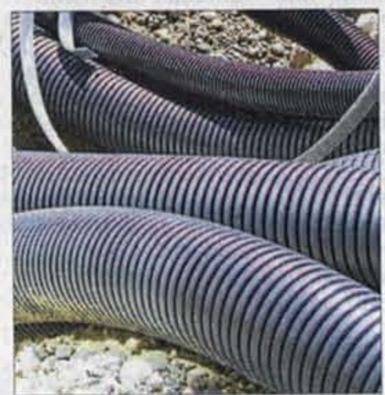
Müssen um- und neu verlegt werden: Stromleitungen sowie Leerrohre (unten) für die Anschlüsse der Weihnachtsbeleuchtung in den Bäumen.
